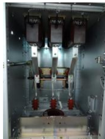
电缆室 Cable room
