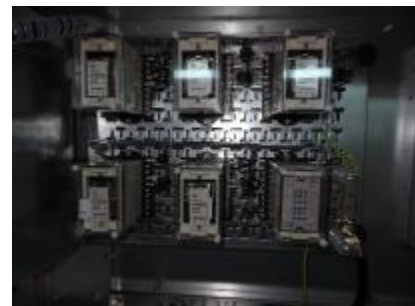
继电器仪表室 Relay meter room
